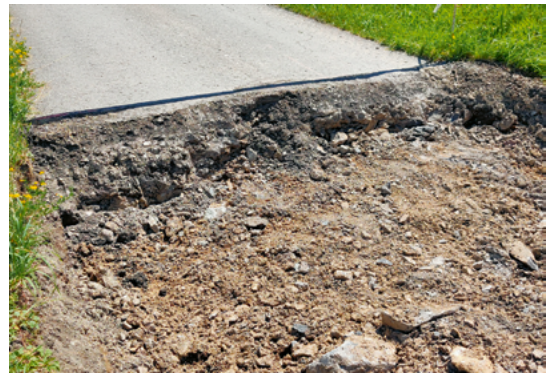
Situation Kofferrung – Ob Späzeren Viel Belag, Kofferrung mangelhaft vorhanden
